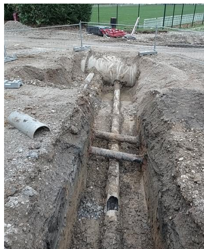
Renouvellement branchement en amiante
